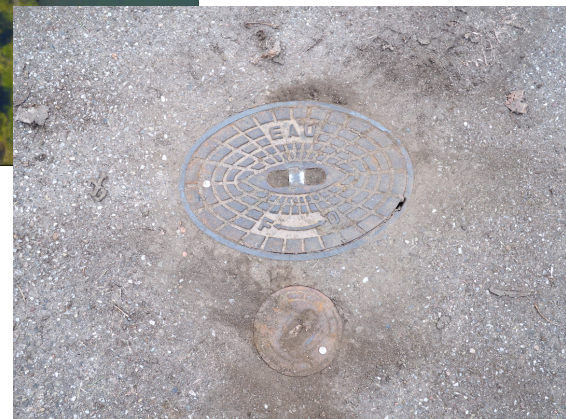
Photo de la bouche d'incendie
